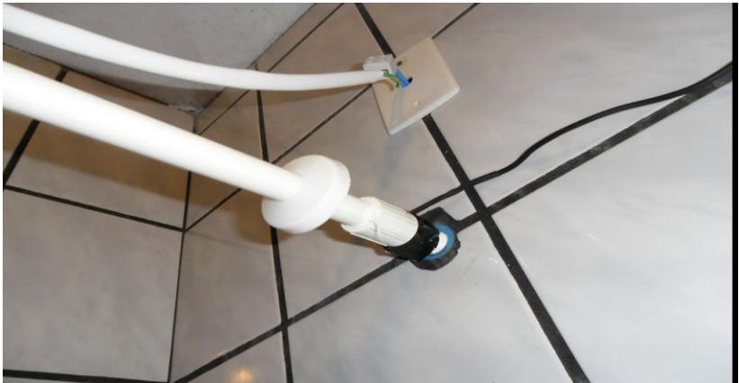
FIGURA 32 - Sensor conectado à entrada do chuveiro.
